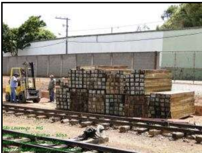
Dormentes novos descarregados na estação de São Lourenço. Foto: Edelmo Dias de Freitas.
