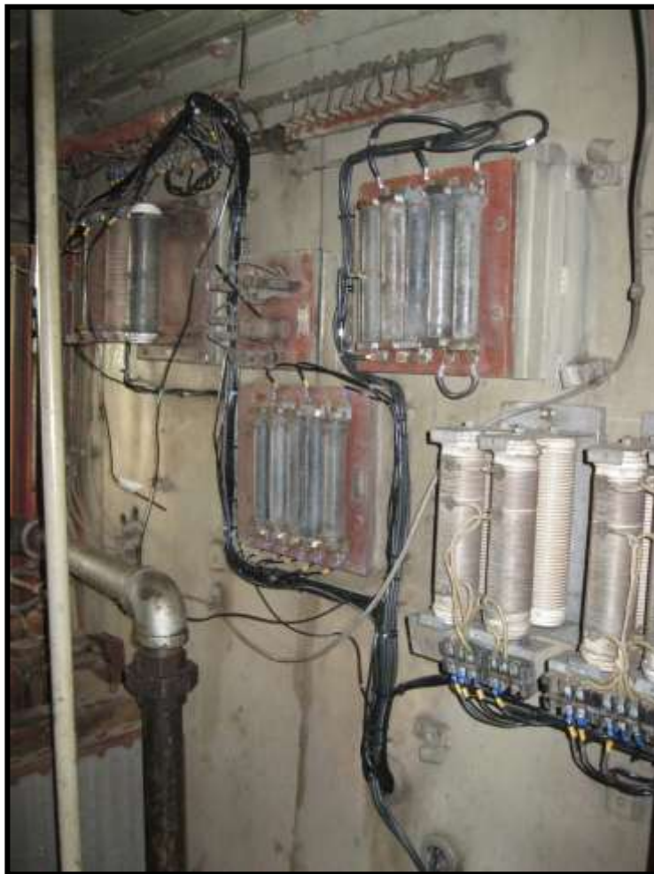
Circuito de baixa tensão da locomotiva 3136.
