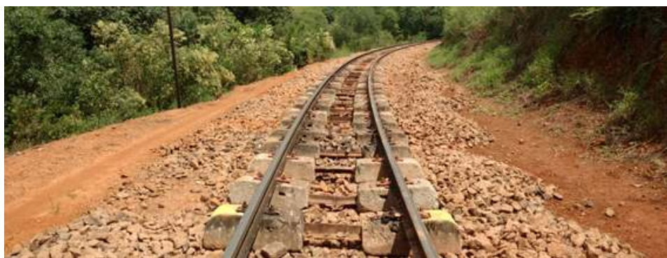
No km 87 estão sendo substituídos todos os dormentes antigos por bi-bloco de concreto. O lastro está sendo descontaminado para ser reaplicado e posteriormente será complementado.
