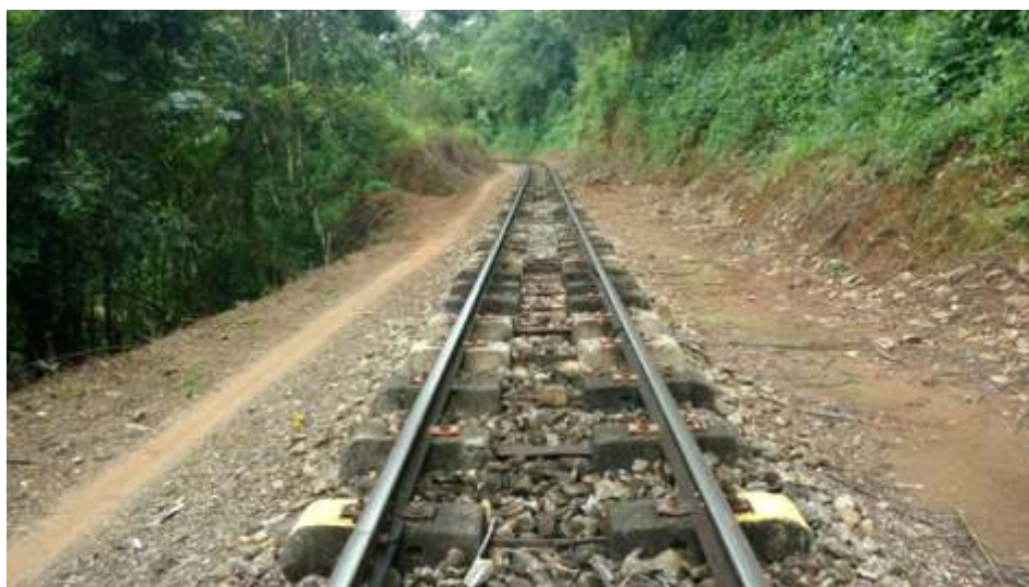
Um deslizamento de terra devido as chuvas chegou a afetar a via no km 86, retirando a grade do alinhamento. A limpeza com remoção da terra foi feita e a via foi corrigida
